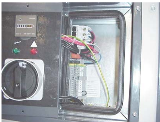
Klemrække i styringen bag højre betjeningspanel
