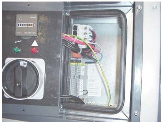
Klemmreihe in der Steuerung hinten dem rechten Bedienfeld
