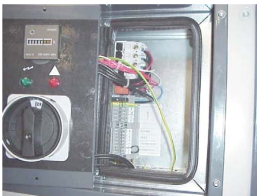
Bornier derrière le panneau de commande droite
